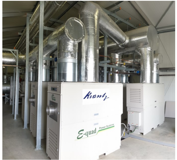
Die Gasturbinenanlage besteht aus sechs Mikrogasturbinen Capstone C65.
