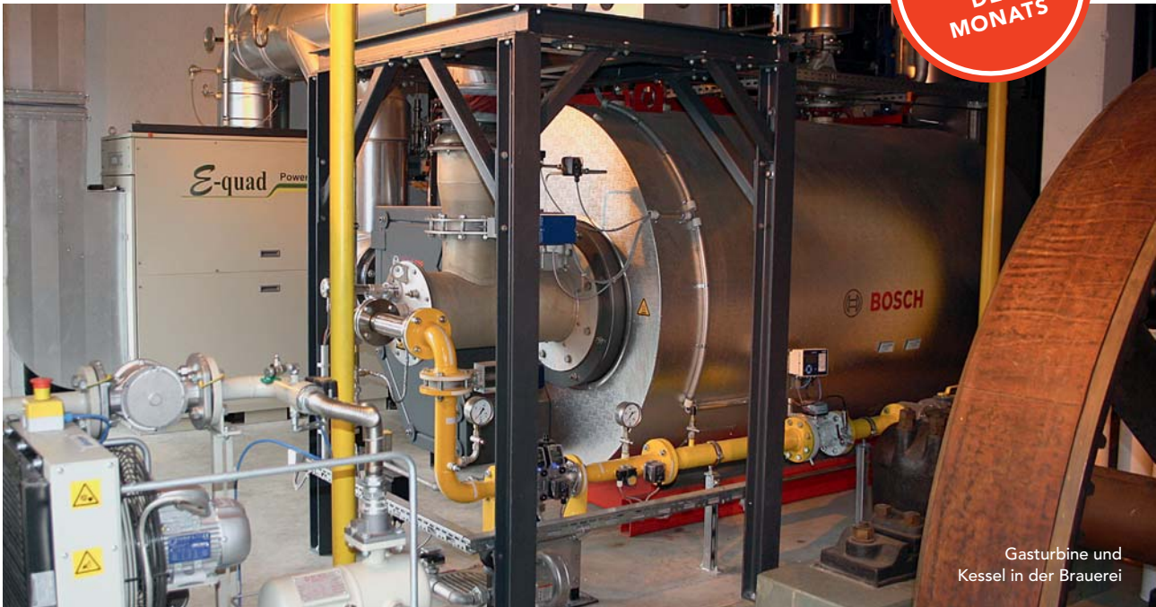
Bild: E-quad Power Systems
